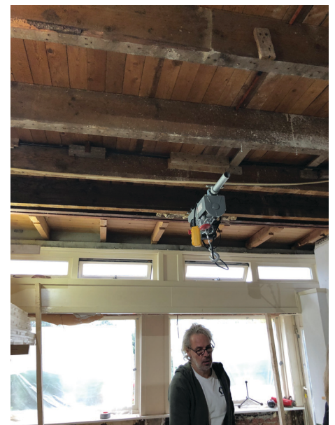
Loszittend plafond verwijderd
