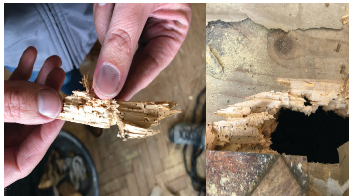
Papaverhof 24: houtworm in de vloerbalken
